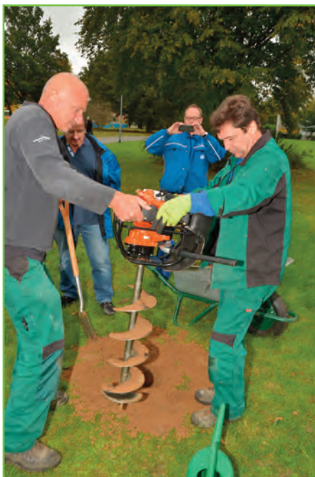
Bohrung für die Verankerung der einzelnen Bauteile der Schlange. Im Hintergrund fotografiert Dr. Hock.
