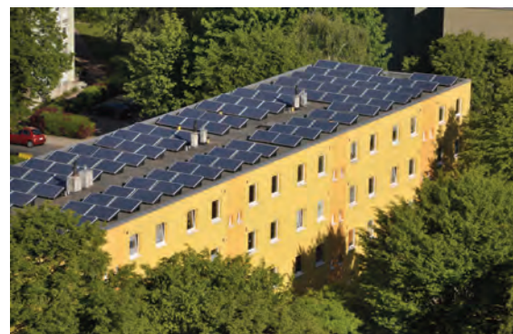
Photovoltaikanlage auf dem Dach des Gebäudes Stromtal 21 - 27.
